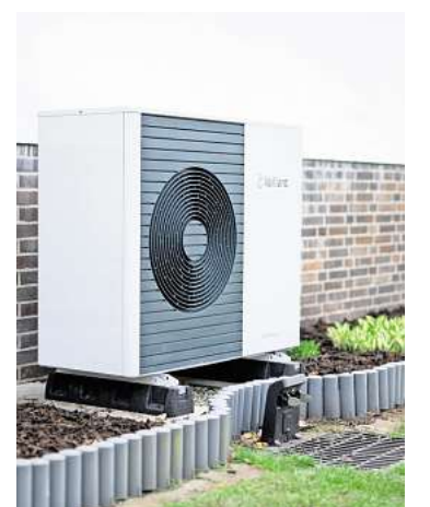
Wärmepumpen sind eine klimafreundliche Art, zu heizen.
